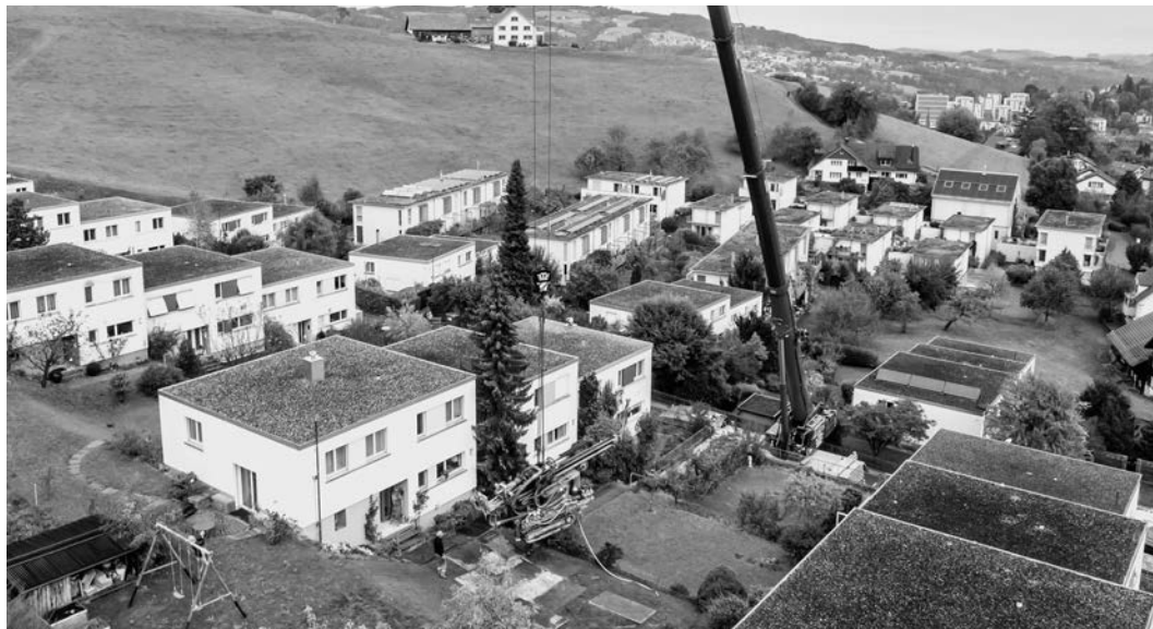
Nachhaltige Wärmeversorgung durch Inauen Heizung: selbst in Wohnsituationen ohne direkten Zufahrtsweg.
