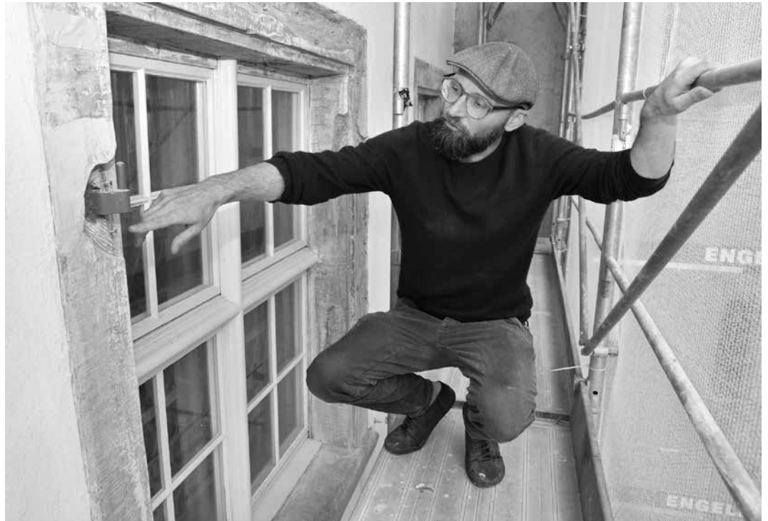
Alte Geschichten werden sicht- und erzählbar: Architekt Christoph Biedermann leitet die Fassadensanierung am Historischen Museum Bischofzell.
