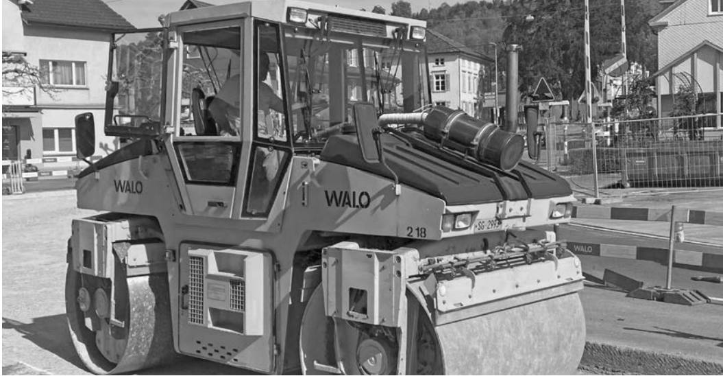
In den letzten Wochen wurde auf dem vierten Abschnitt die Tragschicht eingebaut.
