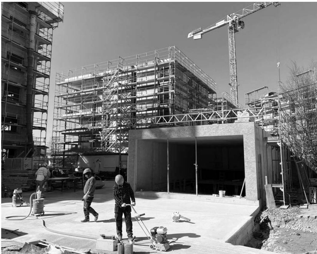
(tw) Der Baufortschritt auf dem Bruggmühle-Areal wird Woche für Woche augenfälliger. (Bild: tw)
