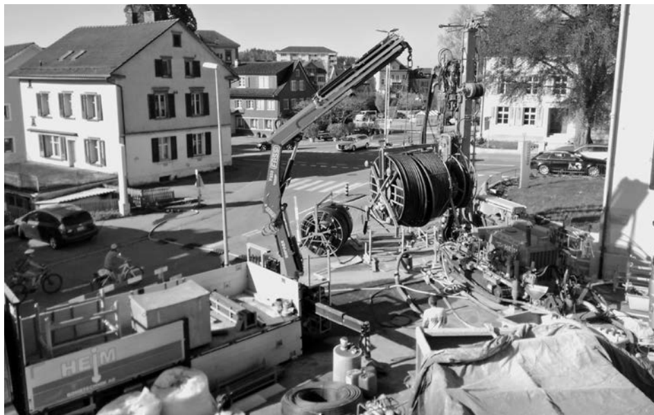
Die beiden hochmodernen Sonden wurden rund 480 Meter tief ins Erdreich herabgelassen, wo sie wesentlich mehr Wärme aufnehmen können als herkömmliche Systeme
